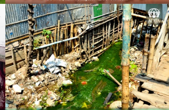
Kde chybí nejen funkční kanalizace...
